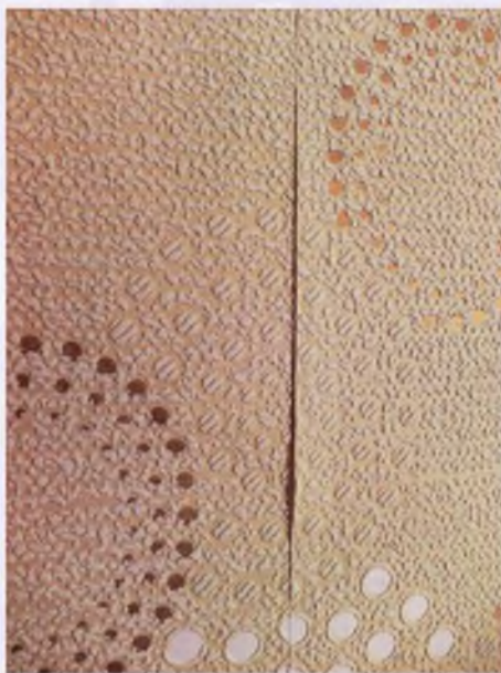
Дефекты при ремонтных работах в быту
