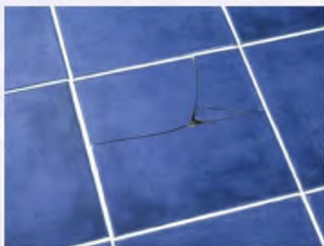
Дефекты при ремонтных работах в быту
